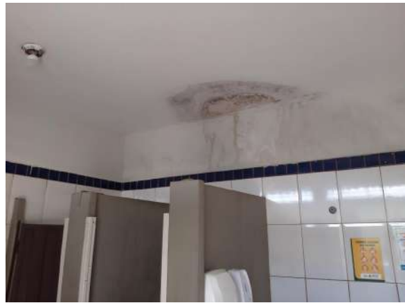
Mofo - banheiro masculino
