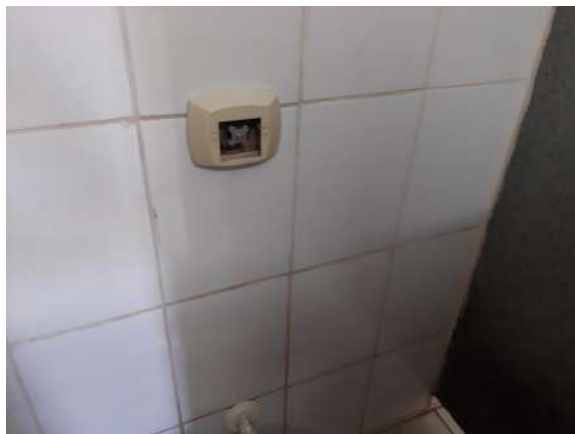
Ausência da capinha para acionamento da descarga
