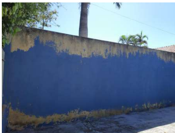
Entrada dos alunos do 5º ano - falhas na pintura (muro)
