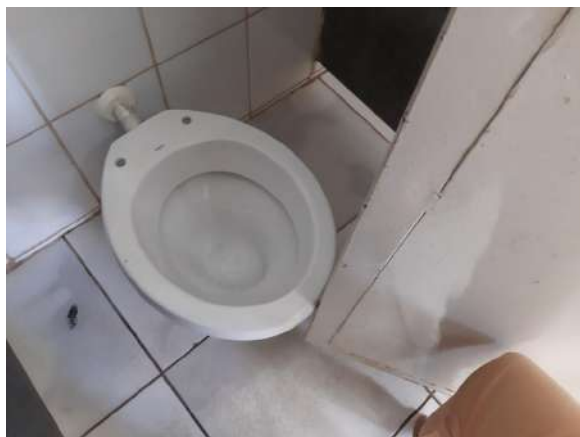
Sanitário masculino - porta sem abertura completa
