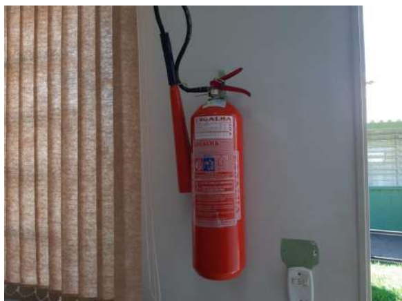
Extintor - sala da direção da escola
