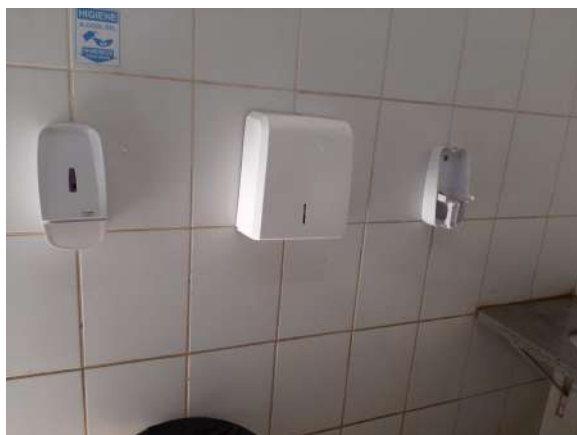
Ausência de sabonete
