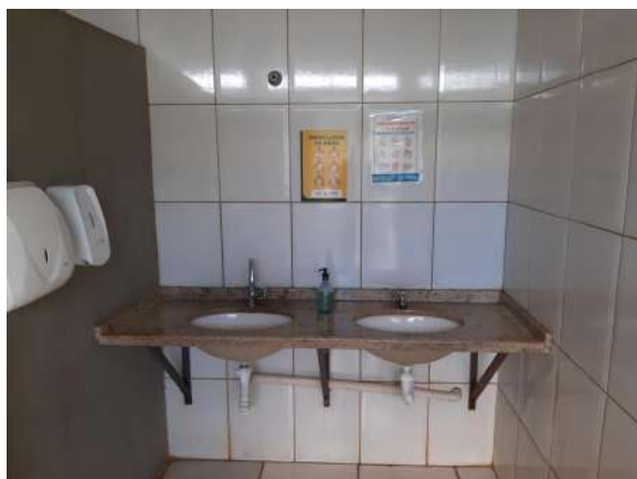
Ausência de sabonete
