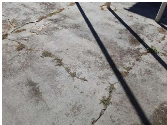
Piso danificado - Entrada - alunos do 5º ano
