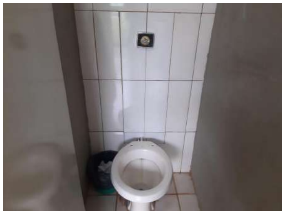
Vaso sanitário sem tampa e sem a capinha da descarga
