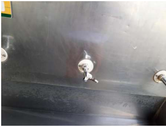
Bebedouro com torneira danificada - pátio da escola
