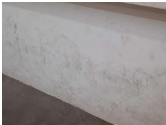
Sujeira excessiva nas paredes.
