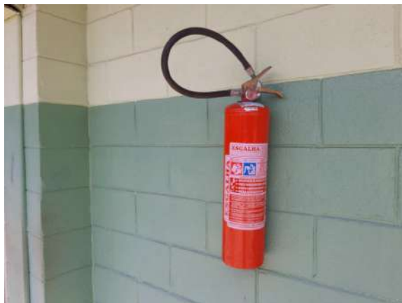
Extintor - corredor de acesso às salas de aulas
