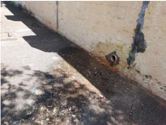
Ar-condicionado - água na calçada da escola
