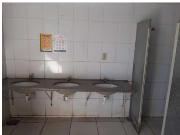
Ausência de sabonete
