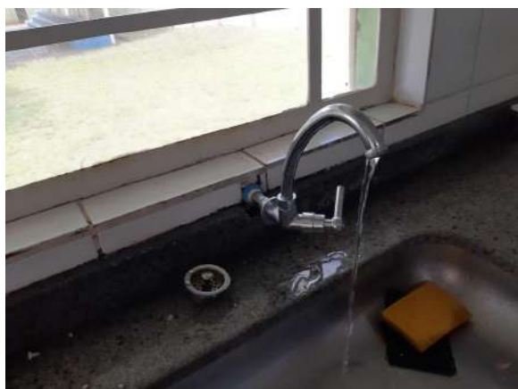
Torneira com vazamento
