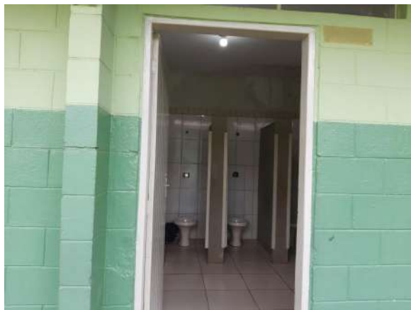
Banheiro sem identificação - mofo
