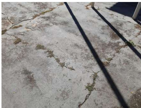
Entrada dos alunos do 5º ano - trincas no chão
