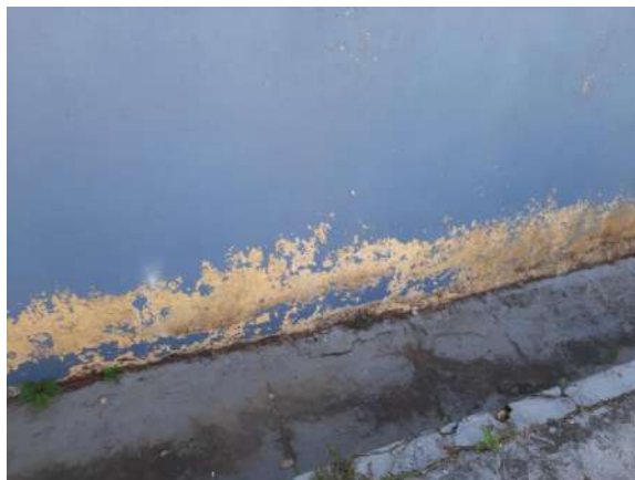
Pintura desgastada e piso danificado - Entrada - alunos do 5º ano
