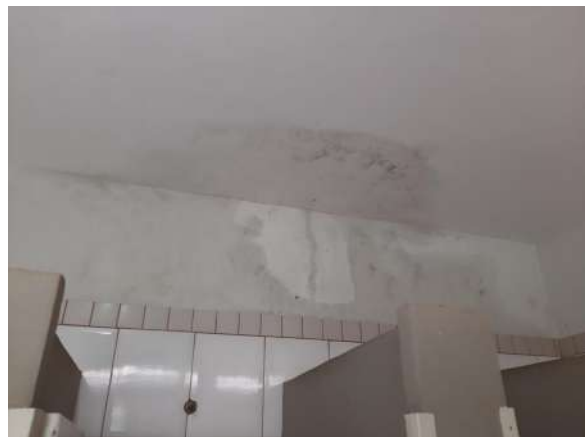
Mofo - banheiro sem placa de identificação
