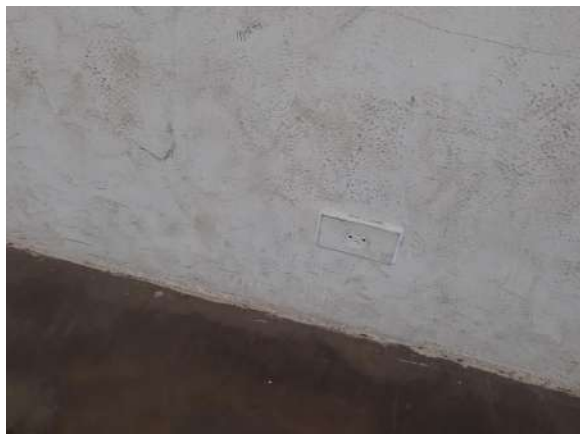
Sujeira excessiva nas paredes.
