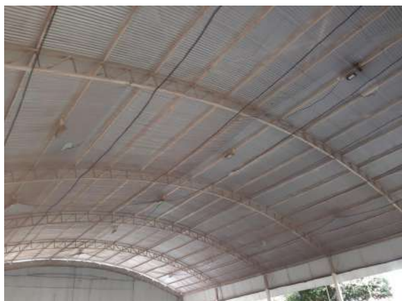
Furos na cobertura
