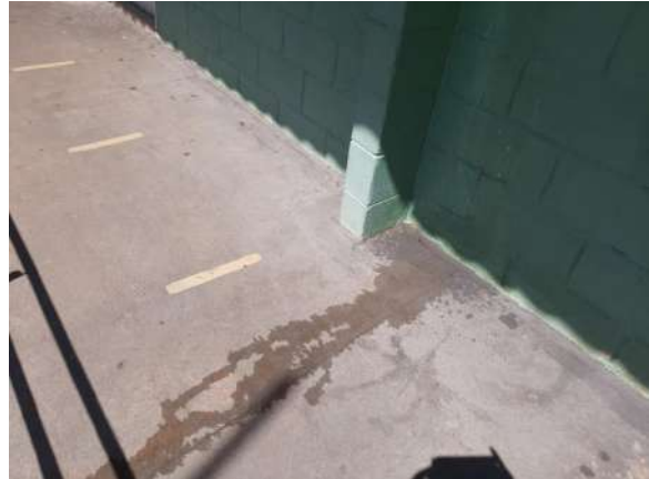
Ar-condicionado - água nos corredores de acesso às salas de
