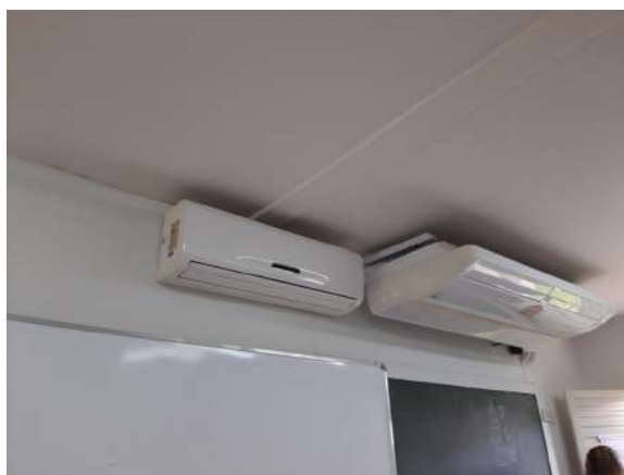
Dois aparelhos de ar-condicionado, dos quais um não funciona -
